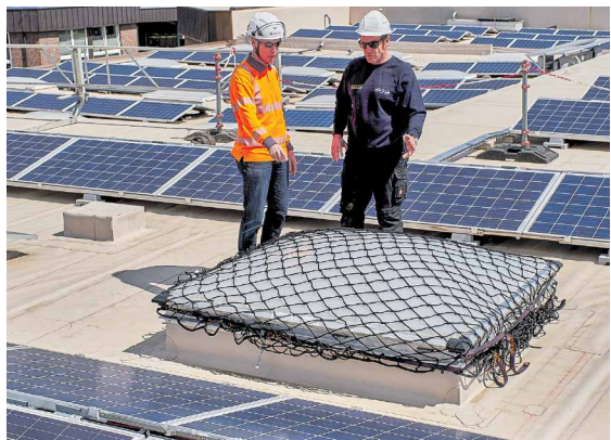
Große Unfallgefahr auf Dächern – gerade auch von modernen Gebäuden – herrscht bei sogenannten Lichtbändern, deren transparentes Material nicht durchbruchssicher ist.
