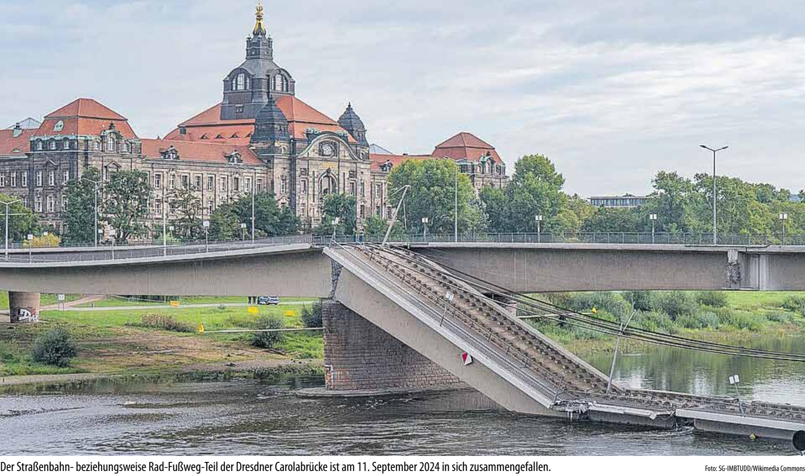
Der Straßenbahn- beziehungsweise Rad-Fußweg-Teil der Dresdner Carolabrücke ist am 11. September 2024 in sich zusammengefallen. Foto: SG-IMBTUDD/Wikimedia Commons
