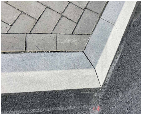
Der helle Farbton der Steine verstärkt die verkehrsleitende Wirkung auf der Straße bei Niedert (Rheinland-Pfalz).
