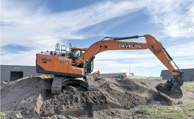
Die Steuerung der Serie 9 erlaubt den Echtzeit-Datenaustausch zwischen den integrierten Sensoren des Develon-Baggers und der 3D-Steuereinheit von Trimble. Foto: Develon
