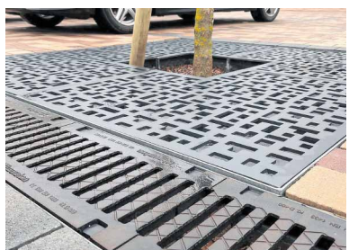
In Reilingen herrscht ein dezentrales Regenwassermanagement. Foto: Hauraton
